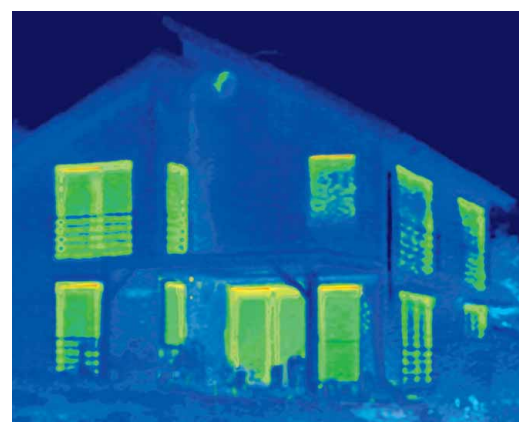
Po svědomité instalaci nových oken Schüco Corona CT 70 Classic dokazuje termografie vysoký energetický výnos investice. Původní energetická ztráta byla téměř beze zbytku eliminována.
